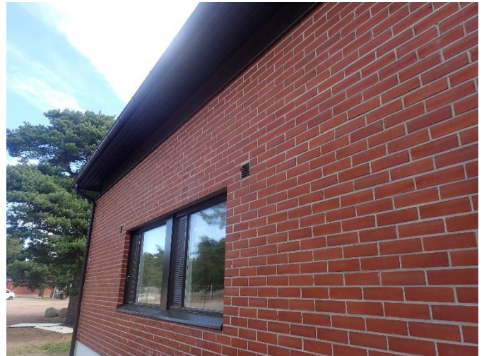
Julkisivussa on vanhat korvausilmaventtiilit.
