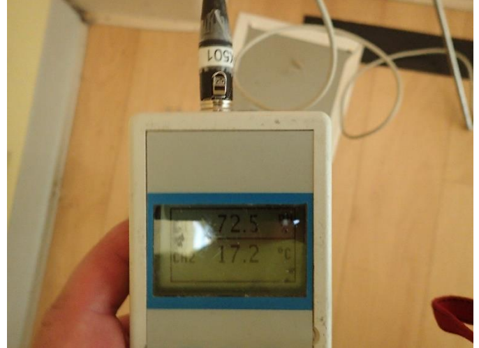
Liikuntasalin eristetilasta mitattiin korkea suhteellinen kosteus.
