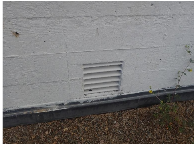
Sokkelissa oleva vanha tuuletusventtiili.
