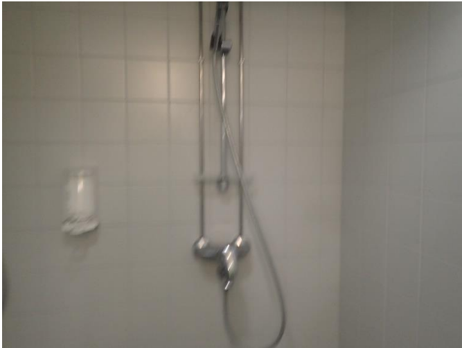
Käyttövesiputket ovat kuparia.
