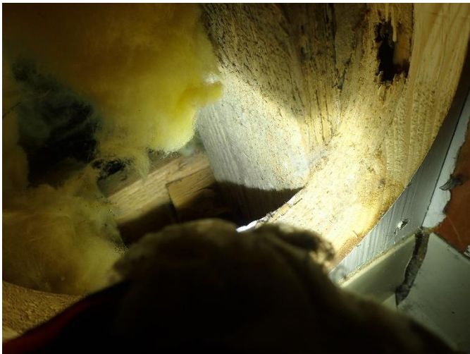
Aikaisemmin tehty rakenneavaus, josta todettiin maakellarimaista hajua.
