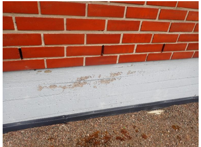
Maalipinnan hilseilyä sokkelissa.
