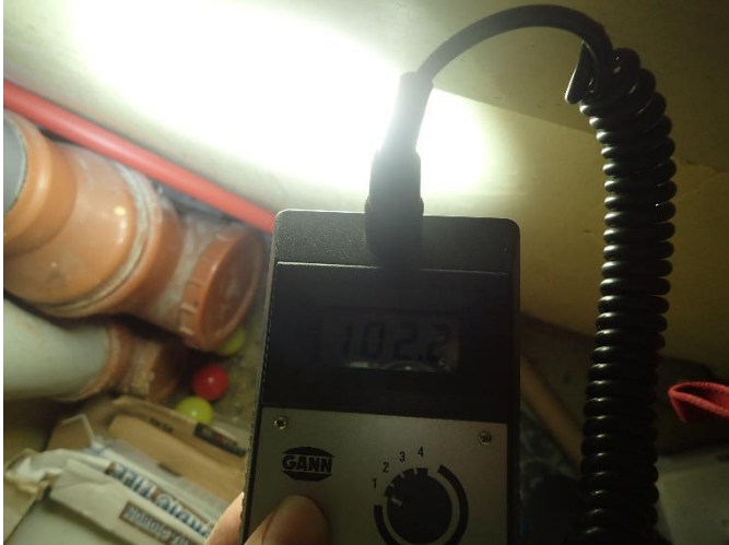
Varastotilan lattiasta mitattiin kohonneita pintakosteusmittaustuloksia.
