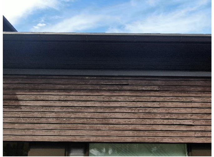
Pinnan maali on välttävässä kunnossa.
