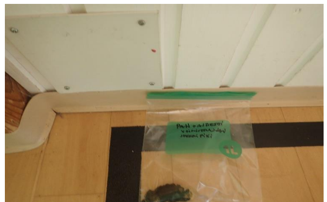
Näyte 6 ja 7 otettiin urheilusalin avatusta seinärakenteen takana olevasta mustasta vedeneristeestä. Näyteestä tutkittiin asbesti ja PAH.
