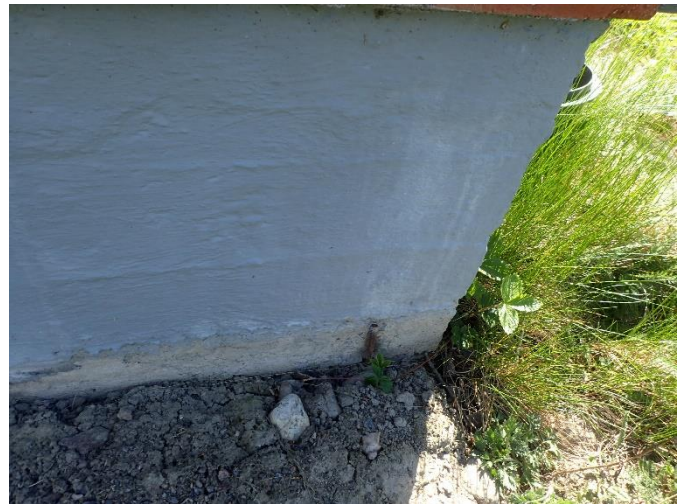
Betoniteräs on ruostunut sokkelissa.
