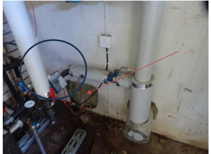
Lämmönjakohuoneessa on seinään tehty reikä, joka on korjaamatta.
