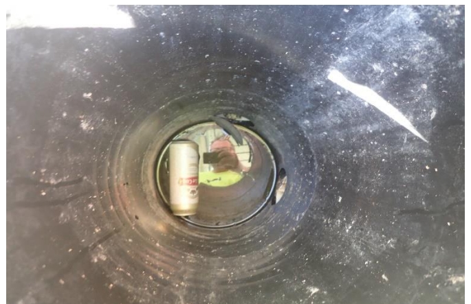
Salaojakaivossa roskaa tukkeena.
