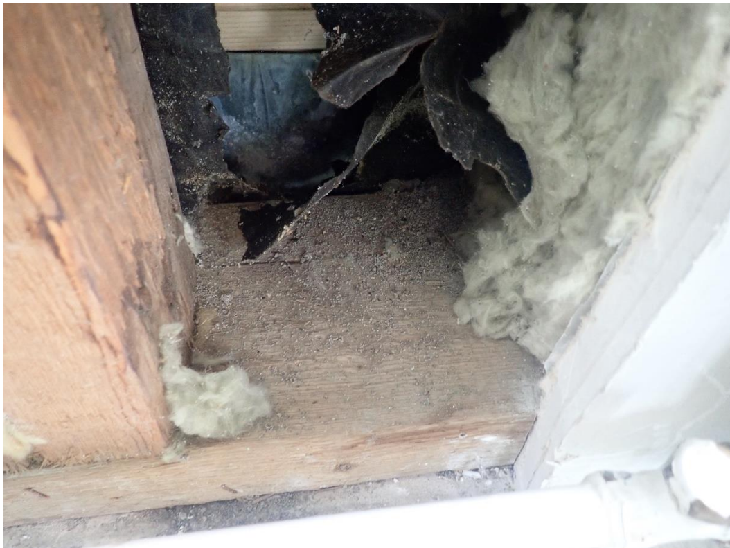
Rakenneavauksissa oli aistinvaraisesti havaittavissa kosteuden aiheuttamia jälkiä (kuva huoneiston A4 toisesta rakenneavauksesta).
