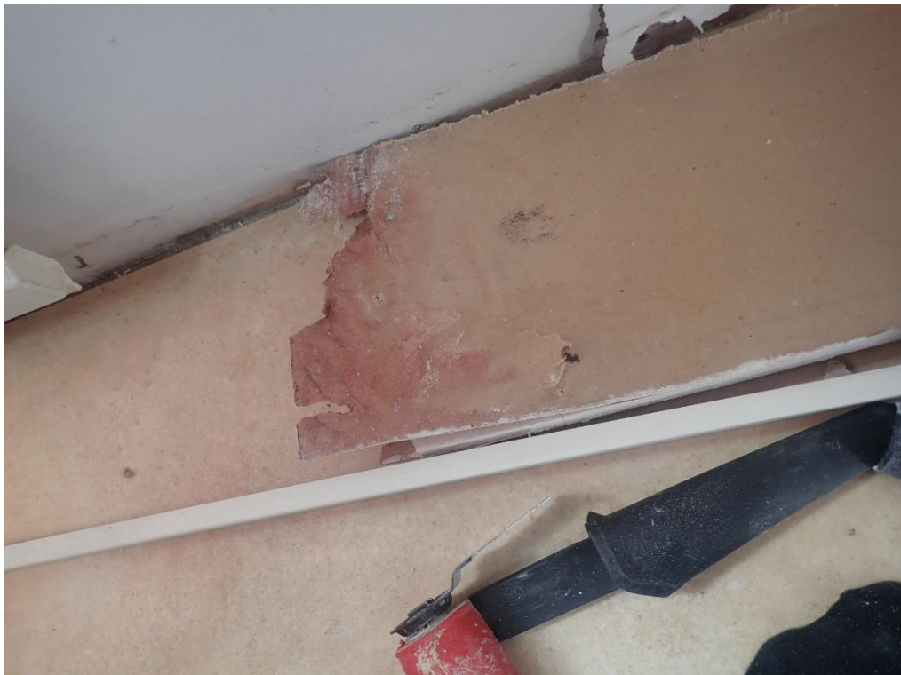
Erityisesti huoneiston B5 keittiön rakenneavauksessa sisäverhousrakenteen alaosa oli murtunut kosteuden seurauksena
