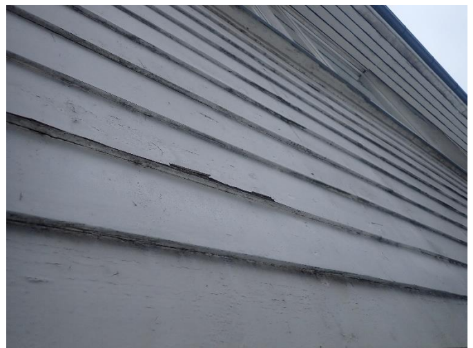
Maalipinta lohkeilee paikoin.
