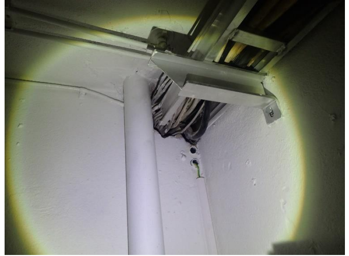
Teknisen tilan läpimenoissa ei ole palokatkoja.
