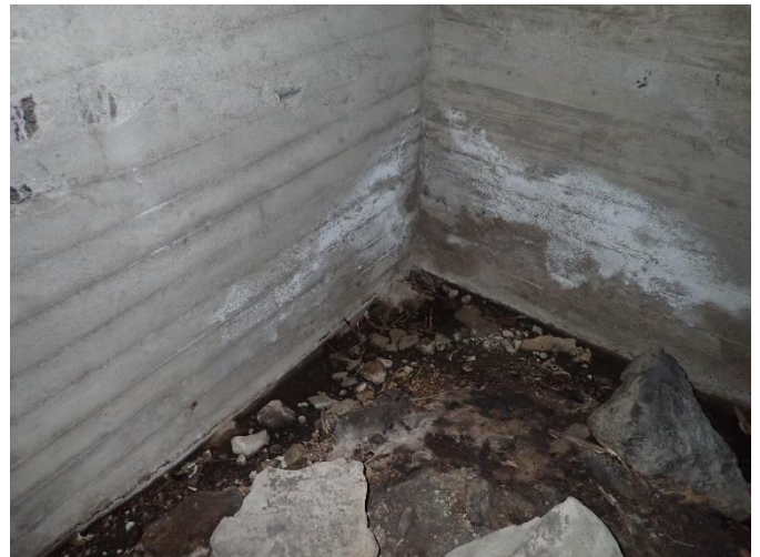
Betonirakenteissa kalkkihärmää ja kosteusjälkiä.
