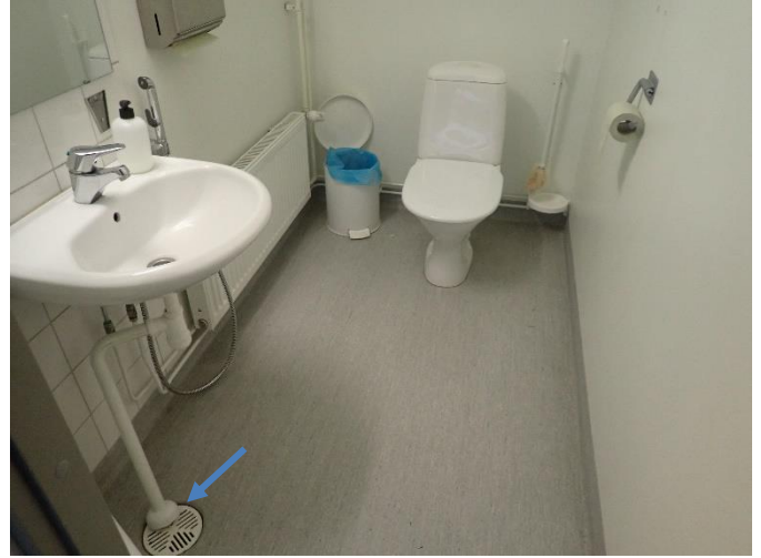
Poikien wc, jossa lattiakaivon tiiviste oli huonosti.
