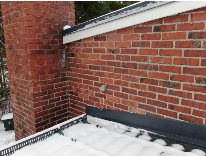
Piipun ja seinän nurkasta on valunut vettä nurkkaan ja rapauttanut tiilisaumoja.
