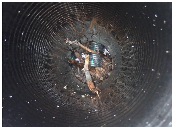
Salaojakaivossa puisia keppejä ja muuta roskaa tukkeena.
