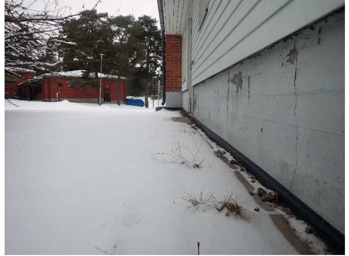
Maanpinnan kallistukset osittain taloa kohden.
