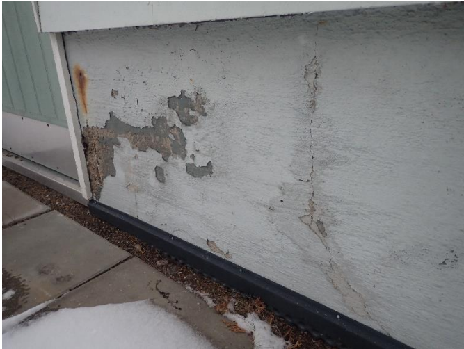
Betonista on tullut esille ruostuneita teräksiä.
