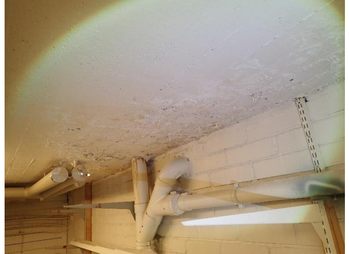
Välipohjan maalipinta hilseilee varastossa.
