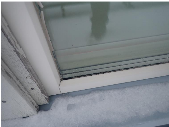
Ikkunoiden kittaukset ovat kuluneet ja ikkunapielilautojen maalipinta hilseilee.
