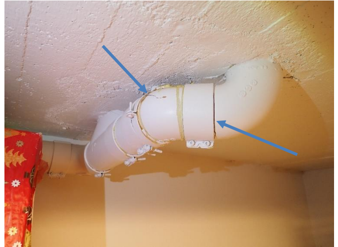
Viemäriputki on halki.
