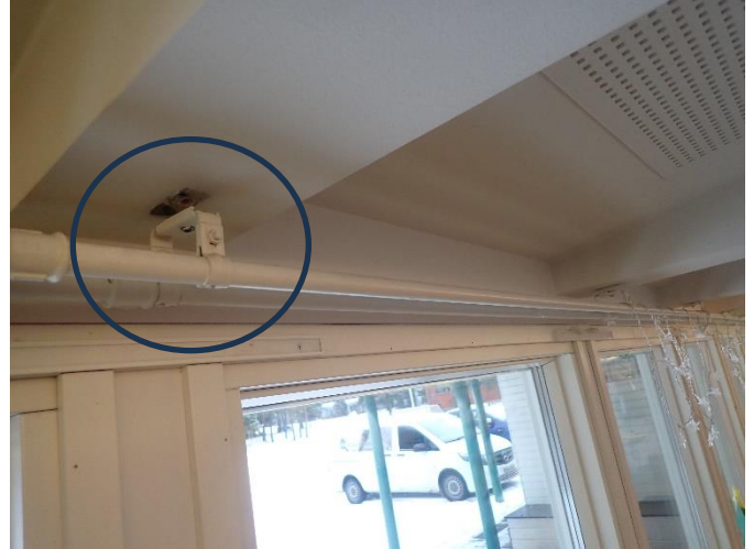
Käytävän lämmitysputkien kannakoinnit olivat irronneet.
