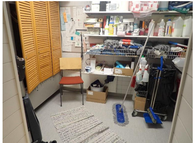
Alakerran siivouskomero, jossa seinälaatat irtoilivat. Tilassa oli tunkkainen haju.
