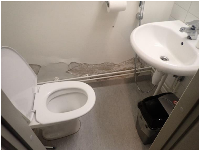
Alakerran wc:ssä seinä pinnoitteet irtoilevat. Altaan hajulukko vuotaa.
