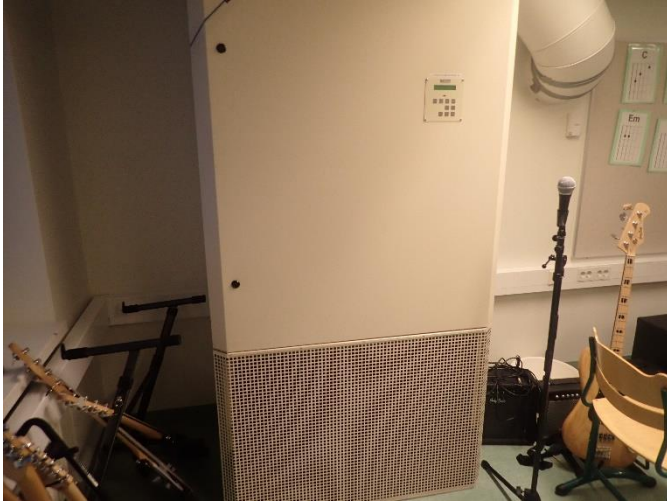
Luokkahuoneisiin on asennettu erillisiä ilmastointikoneita.
