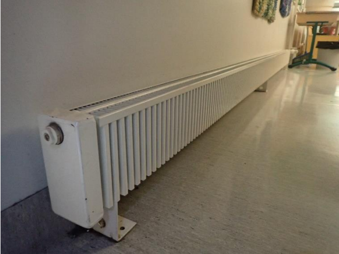
Lämmönjako on toteutettu pattereilla.
