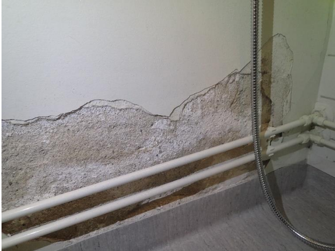
Alakerran väliseinissä oli jälkiä maakosteudesta.
