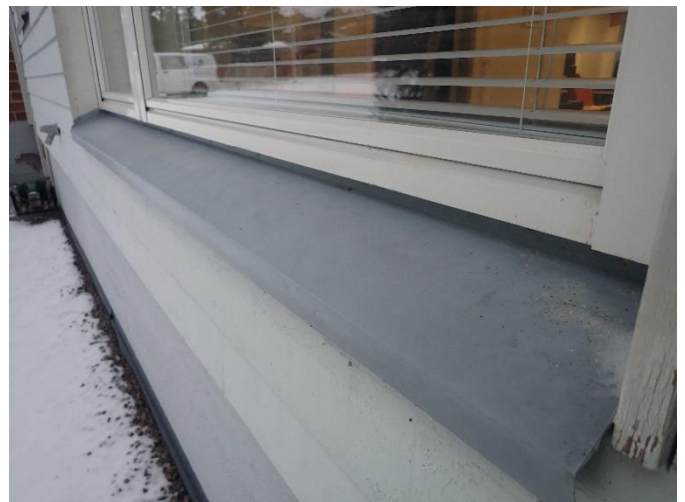
Vesipellit viettävät rakennuksesta pois päin.
