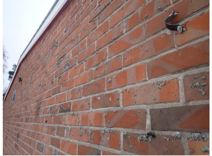
Pohjoispäädyssä on sammalta.
