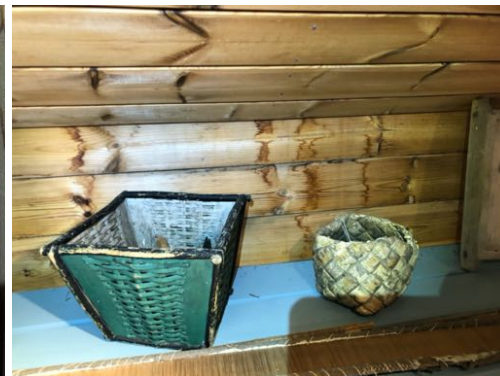
Yläkerran vanhoja vuotojälkiä
