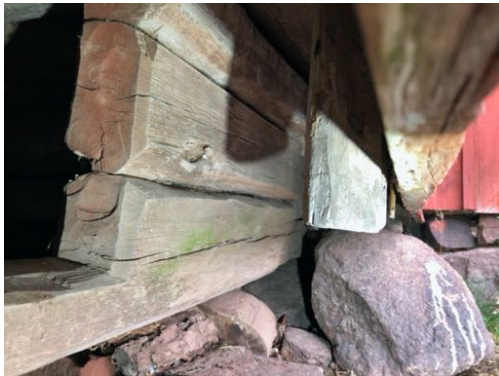
Kuistin seinien pystypilareiden alapuoliset kivipedit ovat osin liikkuneet pois paikoiltaan
