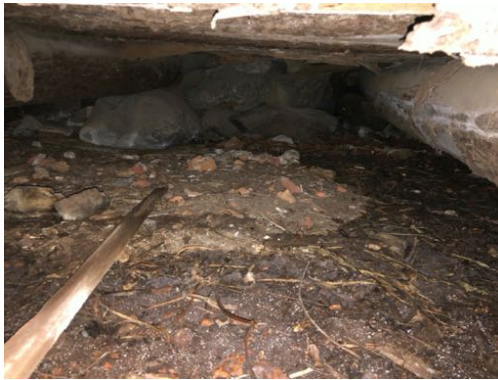
Postihuoneen alta kavattuna ryömintätilan maaperää, joka on paikoin märkää.
