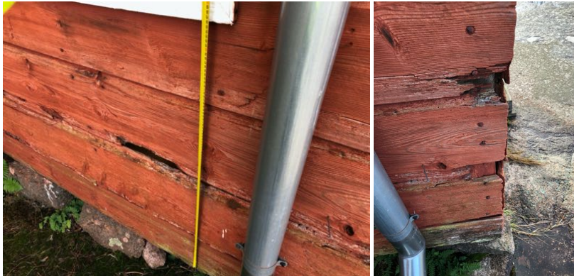
Kuistin pohjoissivun panelointien vaurioita
