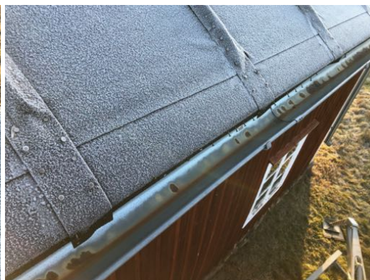
Nanlaukset ovat paikoin räystäällä nousseet ylös
