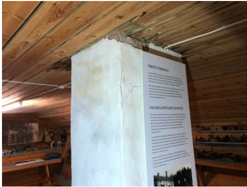
Pohjoisen piipun vuotojälkiä
