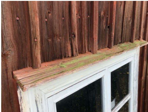
Eteläpään paikallisia puukorjaustarpeita
