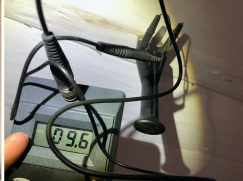
Vauriokohdassa on kuivalaboa
