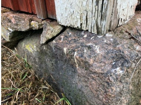
Kaakkoisnurkan nurkkalaudoitus on myös alapäästään hieman lahonnut
