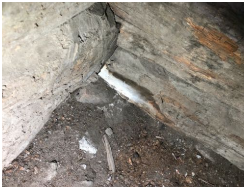
Tuvan kellarin yhdessä alahirressä on pistemäinen kosteusvaurioitunut kobta
