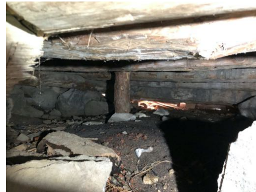
Porstuan hyväkuntoisia alapohjarakenteita, vaikka maanpinta on kostea
