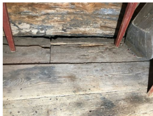
Tuvan länsiseinällä on vanhoja lahovaurioita, joille ei ole välttämätöntä tehdä mitään
