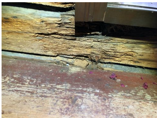
Tuvan eteläikkuna on joskus vuotanut
