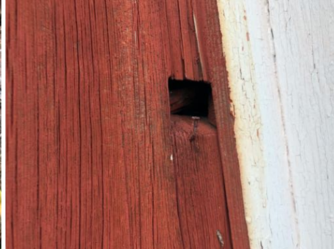
Ikkunoiden suurennyksen myötä vanhojen matalampien ikkunoiden vesilistoista on jäänyt kolot, joissa on ollut puupalaset, joita on pitänyt paikoillaan pönkänaulat.
