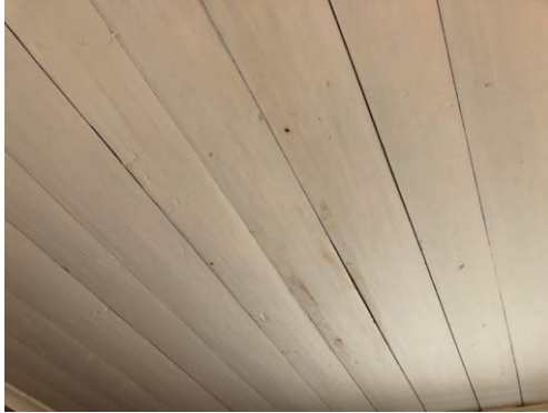
Salin luoteisnurkan vanha vauriokohda
