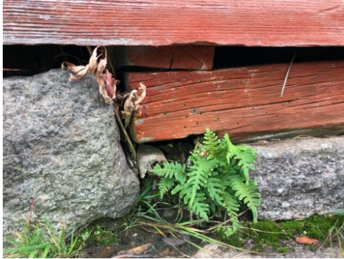
Hirsiarkun pohjoissivun alin birsi on pitkälle labonnut luoteisnurkalta ja painanut rakennetta alaspäin
