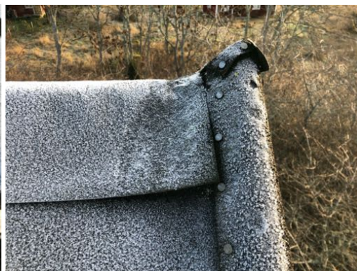
Harjakaistan kiinnitys on irronnut eteläpäädyssä
