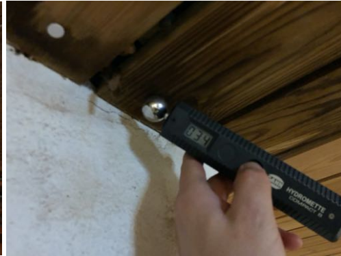
Piiput ovat kosteita tälläkin hetkellä, pintakosteusmittarilla puupinnalla lukema 34%, rappauksen pinnalla lukema 55%.
