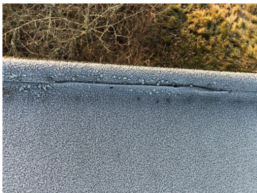
Eteläpään länsilapteen reunakaistan virheellinen limityskohta
