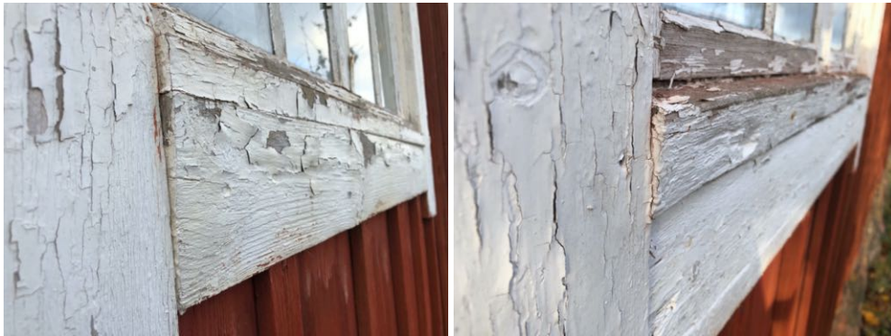
Maito huoneen ja Volter Kilven huoneen ikkunoiden alakarmissa ei ole reunaylitystä/ vesinokkaa lainkaan.
