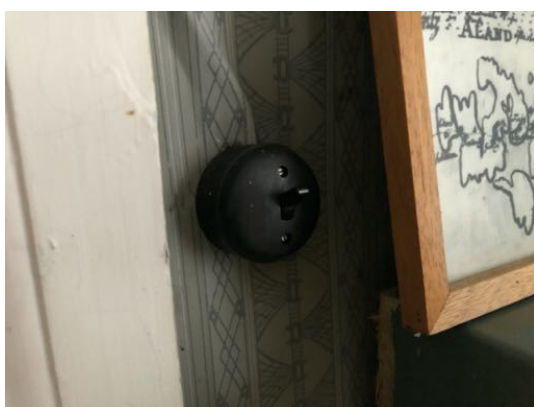
Huoneissa on hieman eri ikäisiä sähkökalusteita
