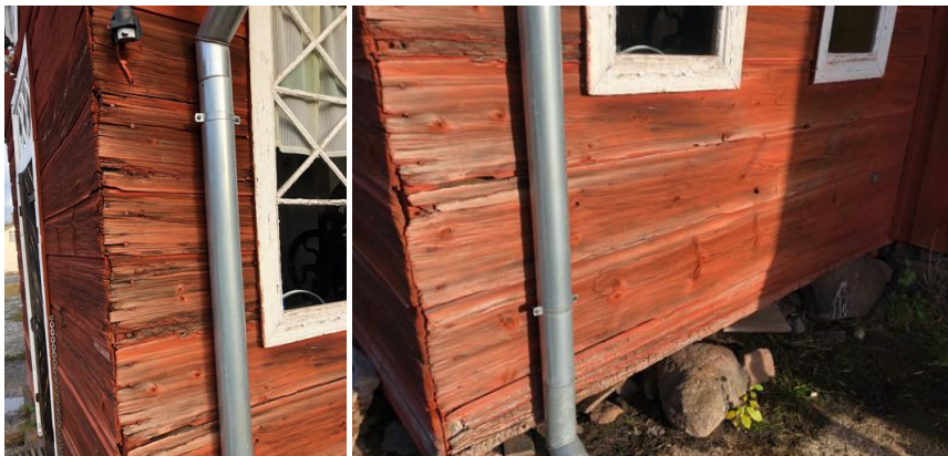
Eteläisivun panelointien vaurioita
